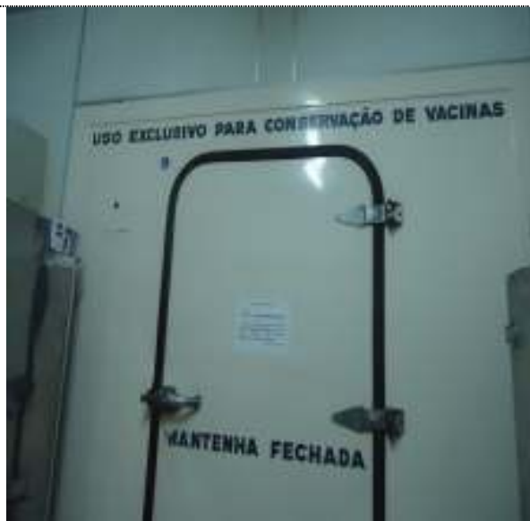
Foto da entrada da câmara frigorífica na UNICAT em Natal (1ª quinzena de setembro de 2014).
