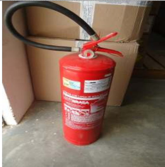
Foto 5 da sala principal para armazenagem de medicamentos CEAF na UNICAT em Natal (1ª quinzena de setembro de 2014)- Detalhe: único extintor da sala, de água.
