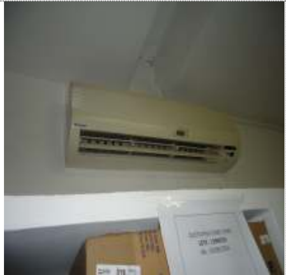
Foto 6 da sala principal para armazenagem de medicamentos CEAF na UNICAT em Natal (1ª quinzena de setembro de 2014)- Detalhe: aparelho de ar condicionado sem utilização (danificado).
